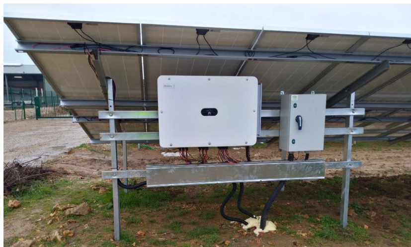
Figure 12 : Onduleurs photovoltaïques fixés à la structure porteuse des modules (Source SOG SOLAR)
